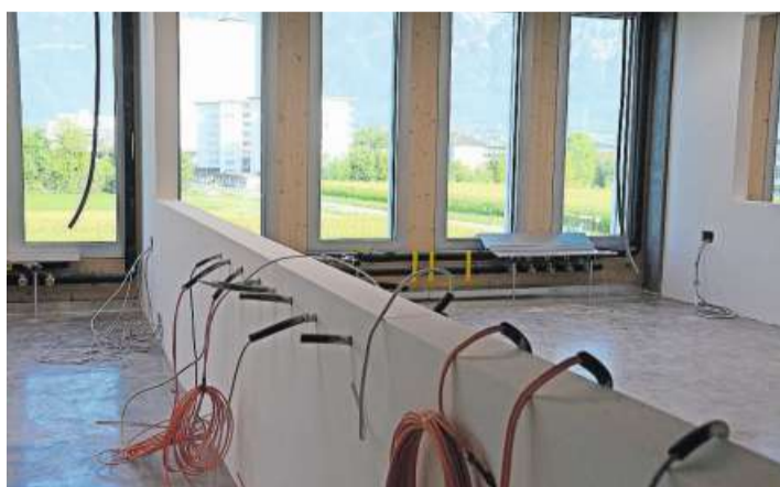
In den Laboren werden zahlreiche technische Anschlüsse benötigt.
